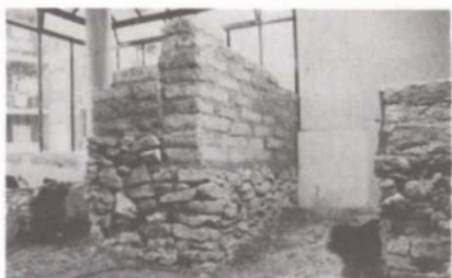
FIG. 22 Construction d'un mur de refend sans chaînage avec la façade. Photo G. Xuereb (Martigues Communication).
