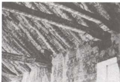
Dramático estado de conservación de la mayor parte de las iglesias decoradas con pintura mural.
