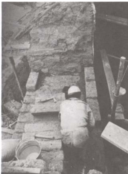
Las técnicas que pueden ser correctas para la consolidación de los muros de adobe, pueden afectar la pintura mural.
