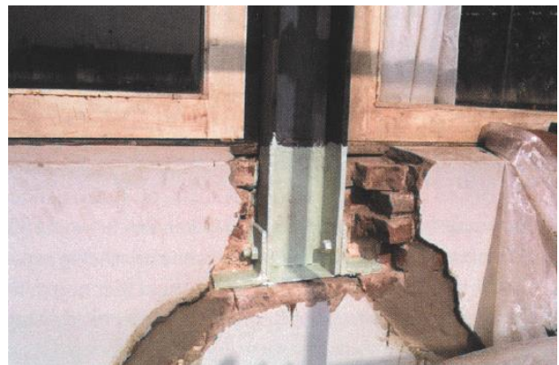
Foto 12 De stalen kolom is in 1974 voorzien van corrosiewerende verf en ingepakt in kunststofmortel.
