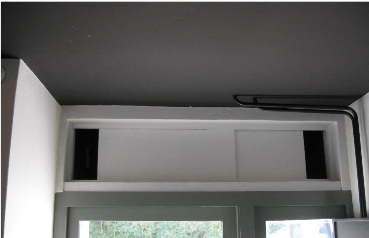
Foto 4 Dragende vloerbalken zijn door het plafond niet zichtbaar
