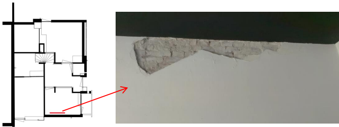
Figuur 1. Schade in de vorm van loslaten van het pleisterwerk in de studeerkamer van het Rietveld Schroder Huis.
