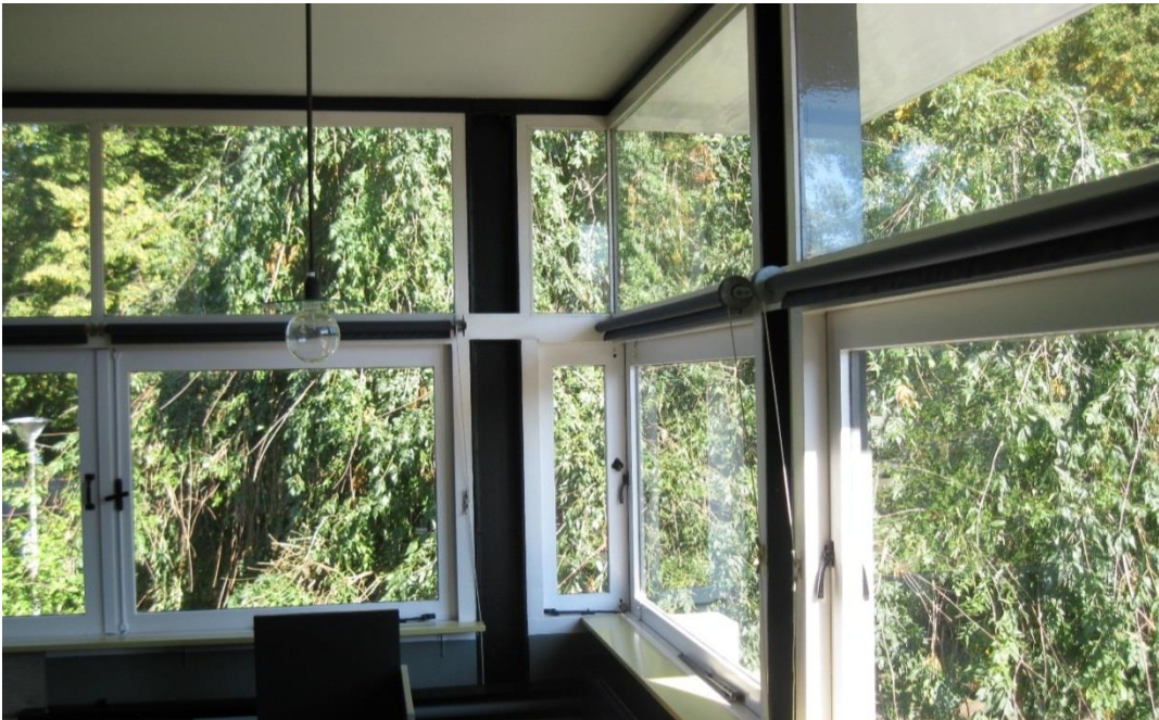
Foto 5 ongeïsoleerde pui met enkelglas en ongeïsoleerde staalprofielen. Dragende dakbalken zijn door het plafond niet zichtbaar
