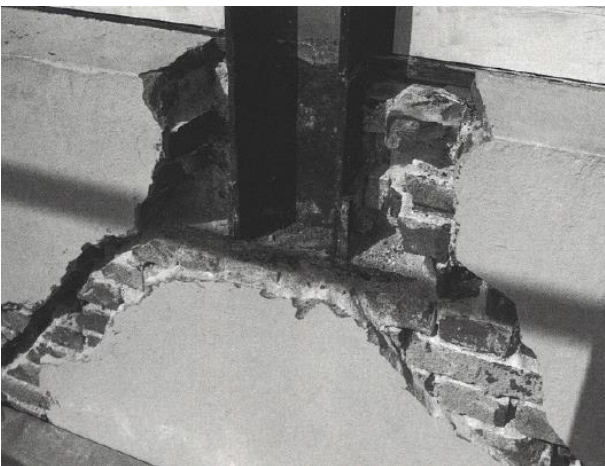
Foto 11 Stalen kolom boven het keukenraam gedragen door metselwerk. De doorbuiging van de ondergelegen stalen latei veroorzaakte diagonale scheuren.
