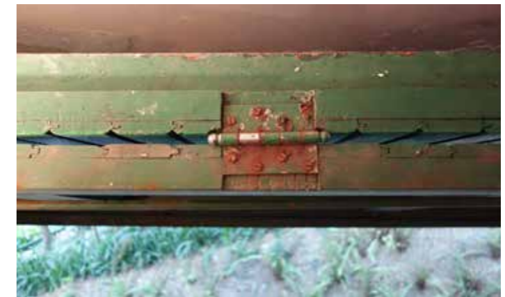
Esquadria portão. Detalhe da articulação das folhas do portão, destaque para a oxidação na dobradiça
