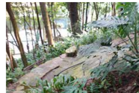
41 fissura na borda do arrimo. Trecho impermeabilizado para receber queda de águas pluviais da gárgula
