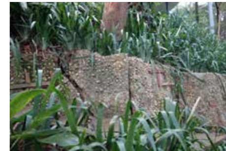
36 Mureta trincada pelo crescimento do tronco da árvore.
