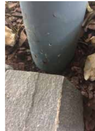
Imagem 1: Furo no pilar
