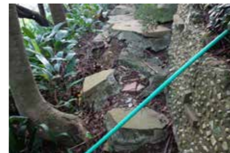
35 Tubo de água fria interrompendo caminho. Piso de pedra solto e deslocado da posição original.
