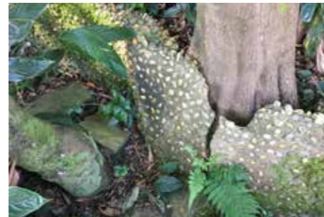
22 Trecho de mureta com tronco de árvore e raízes elevando as pedras de arenito vermelho do percurso.
