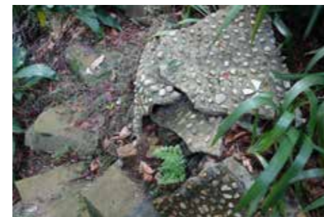
33 e 34 Mureta em ruína.
