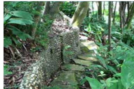
24 percurso desestabilizado devido a rompimento e deslocamento de mureta de arrimo e do assentamento das pedras de piso.
