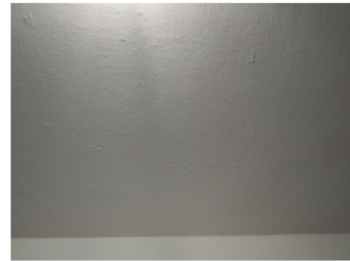
Vista do revestimento do forro, com sinais de irregularidade na argamassa
