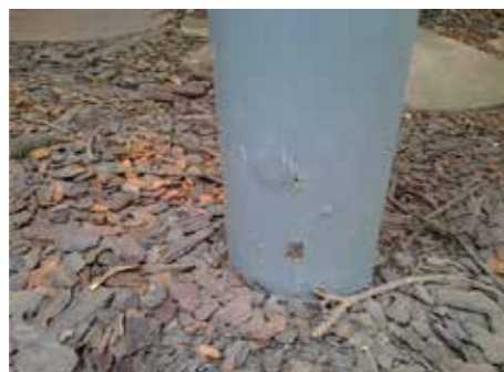
Pilares com oxidação que expulsa a película de pintura.
