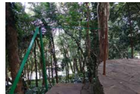
Corrimão da escada (PA.02.03) junto à rampa de veículos (PA.02.04). Recomposição após dano por choque de veículo.
