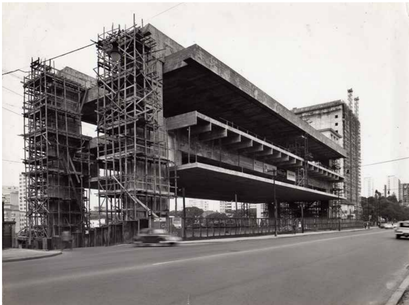
Figura 4 Construção do Museu de Arte de São Paulo, arquiteta Lina Bo Bardi, 1957 – 1969, São Paulo. Fonte: IB. Foto: Hans Gunter Flieg, 1968.
