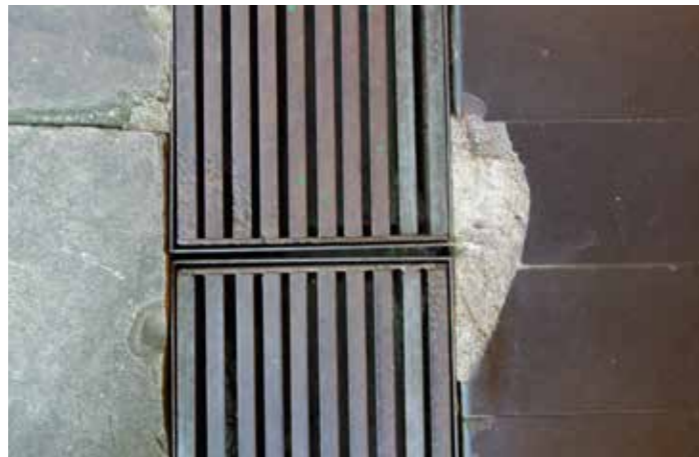
Piso interno danificado junto à grelha
