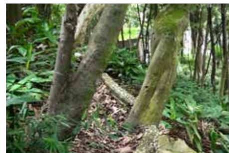
26 mureta de arrimo rompido devido ao crescimento da árvore na borda (árvore morta).
