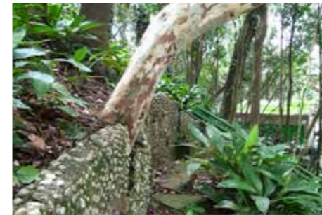
29 imagem fotográfica do trecho de mureta rompido devido ao crescimento de árvore na borda (árvore viva).
