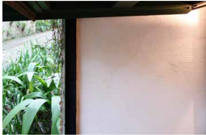
Revestimento das paredes internas junto ao trilho de guia do portão
