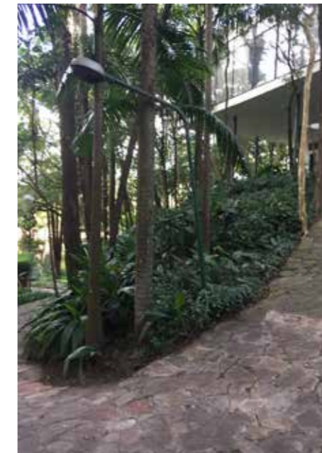
Curva da rampa entre o lance de entrada e o acesso à casa. Observar danos nas pedras do piso.
