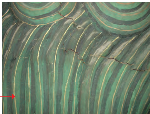
狮鬃毛上的裂缝。
