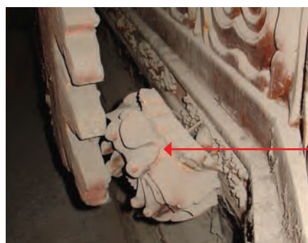
塑像底座漆面剥落和大面积脱落。
