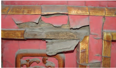
彩绘地仗的裂缝、空鼓脱落非常普遍。
