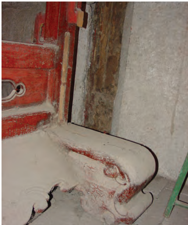
底座的装饰构件已缺失和厚重的灰尘。
