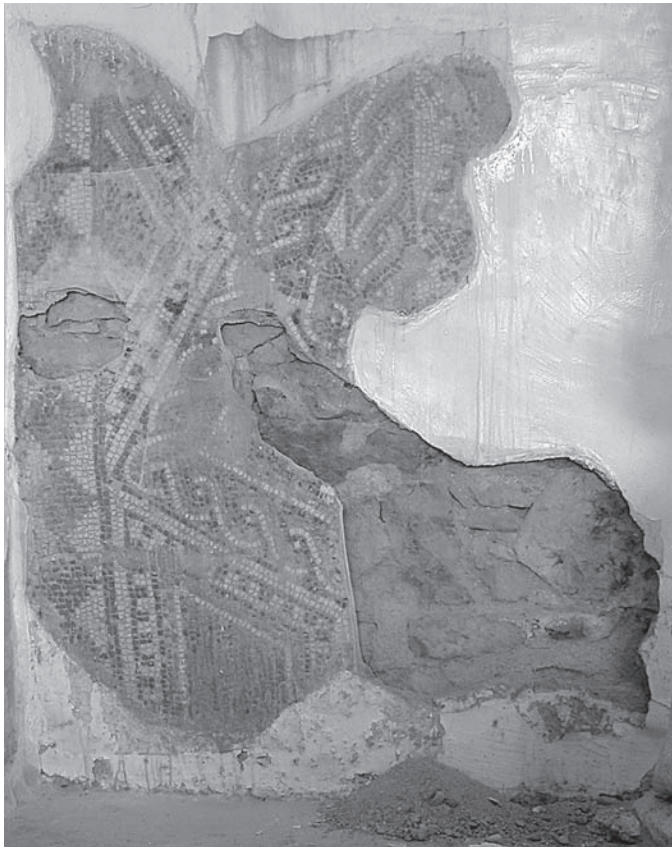
FIGURE 6 Entoilage d'urgence sur la mosaïque à étoile de trois carrés afin d'éviter la perte de tesselles dans les zones de désagrégation des mortiers. Photo © ACRM / MAPA.
