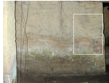
Mancha en base de muro por humedad capilar.
