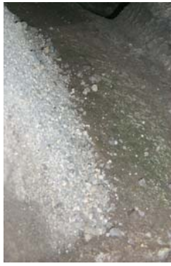
Disgregación en muro.
